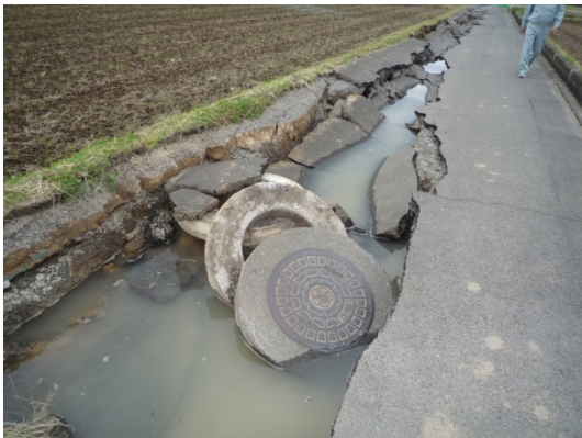
下水道を直さないと車が通れない
