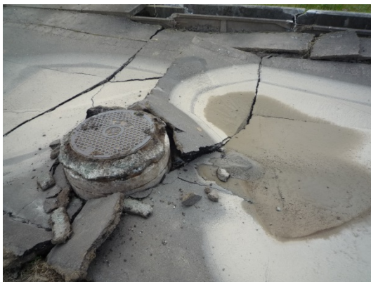
マンホールの突出
